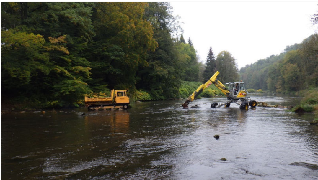
Abb. 4: Eingesetzte Baumaschinen für das Störsteinfeld. Links: Kettendumper; Rechts: Schreitbagger Menzi Muck A 91
