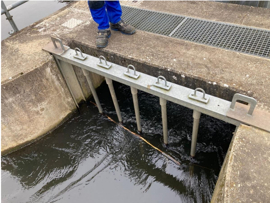
Foto 1: Gesamtübersicht Grobrechen Wehranlage
