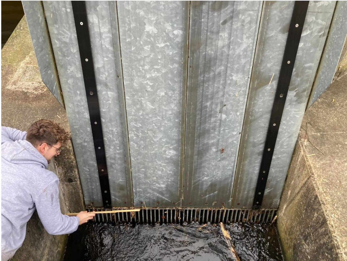
Foto 3: Gesamtübersicht Feinrechen Wehranlage
